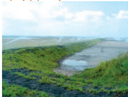
Sistem za kvašenje novoizgrađenih nasipa koji su zaštićeni travnim pokrivačem
